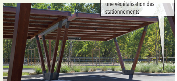
Exemple d'ombrière photovoltaïque sur parking de zone commerciale, Aubrilam.
